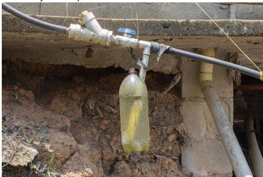
Figura 95. Sistema casero de conexión de agua.
